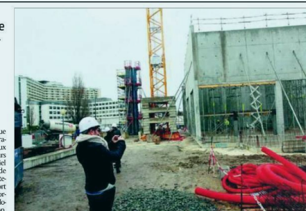
Les chaudières vont arriver bientôt dans le bâtiment. Premiers tests en novembre. (en photo) THIÉRIE GAYOT
